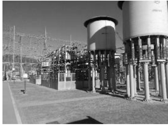
(6) 主变无功补偿区
