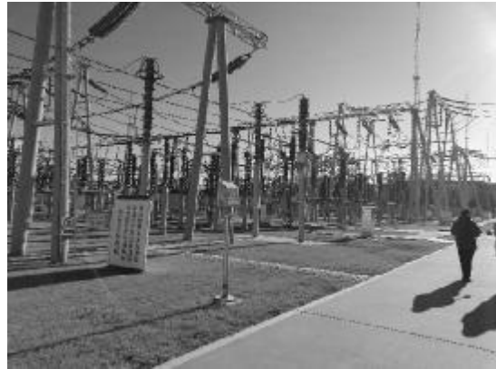
(8) 室外 220kV 配电设备区
