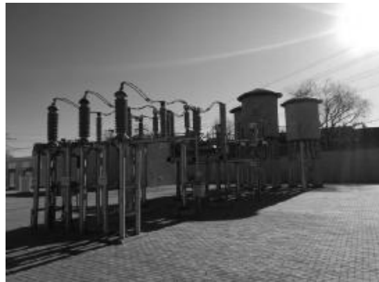
(2) 本期新增 66kV 电抗器
