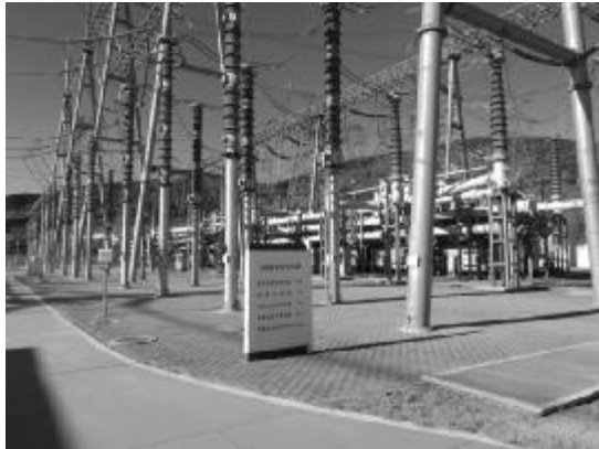
(7) 室外 500kV GIS 设备区
