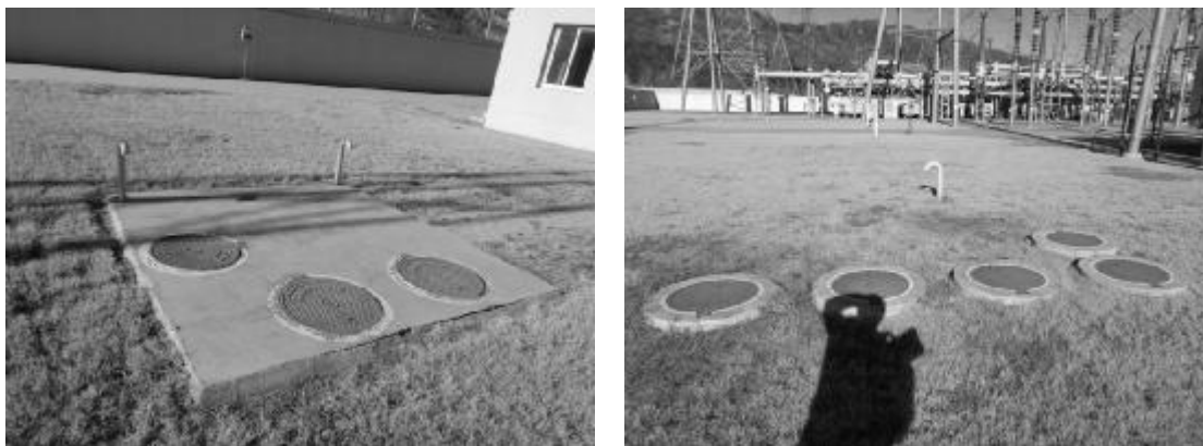
(1) 污水处理装置
