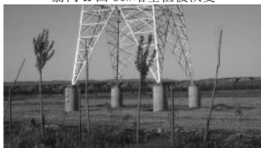
蔚门 I 回 68#塔基植被恢复
